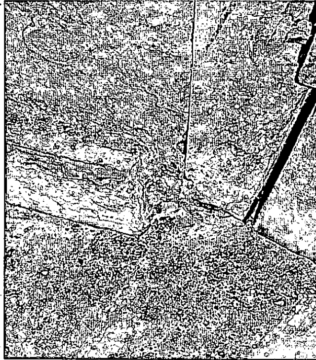
Nido de hormigas en el piso del depósito
